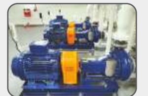
Su ve Kanalizasyon Pompaları
